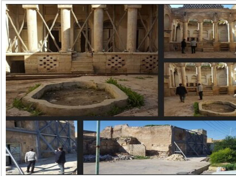
حال انجام است. حداد خاطرنشان کرد: مرمت، احیا و بهره‌برداری صحیح از بناهای تاریخی منجر
