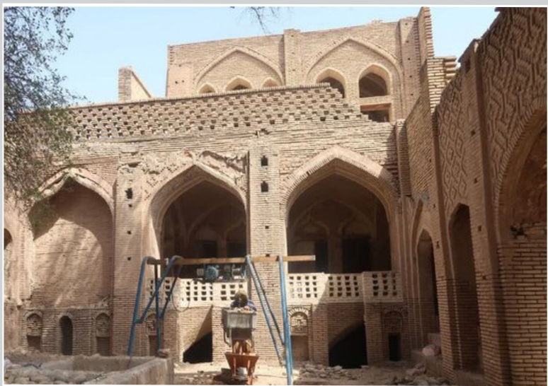
بخش‌های فروریخته شامل اتاق‌های طبقه همکف واقع در جبهه جنوبی و اتاق‌های طبقه اول بنا، بازسازی
